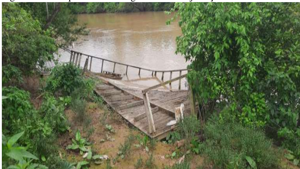
Figura 8 - Deck quebrado às margens do Rio Itajaí Açú.
